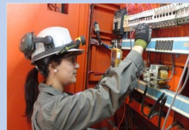
INSTALACIONES ELECTRICAS Y AUTOMATICAS
